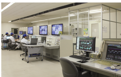
4 中央操作室/Control Room
